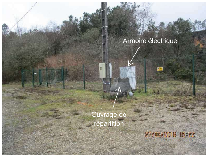
Figure 13 : Vue du regard de répartition et de l'armoire électrique de la réserve Barazer
